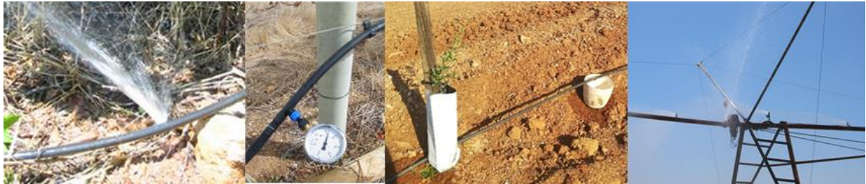
Figura 4.4 – Controlo da pressão, fugas e caudal
