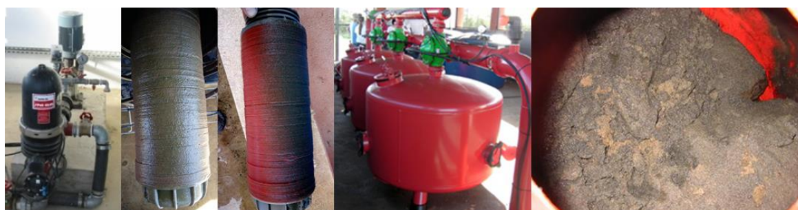
Figura 4.3 – Controlo da pressão no sistema de filtragem e manutenção
