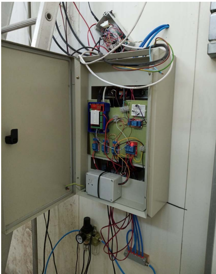
Figura 5.18: Sistema de controlo da camara de cura
