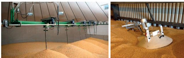
Figura 4 – Agitadores de grão instalados nos locais de armazenamento para facilitar o arejamento e arrefecimento.
