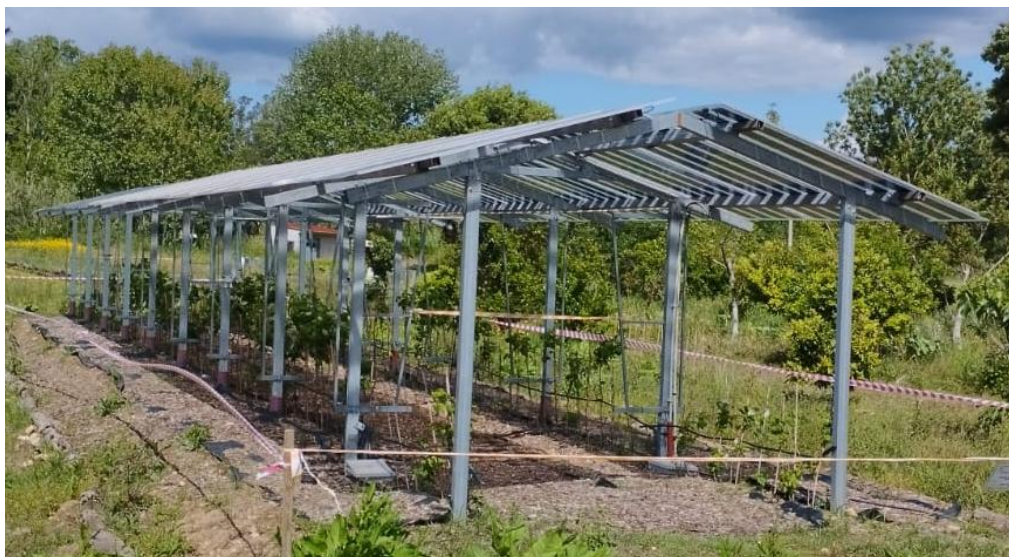
Figura 1 - Piloto de framboesas em agrovoltaiico localizado no AgroBioTech, ESAC-IPC
