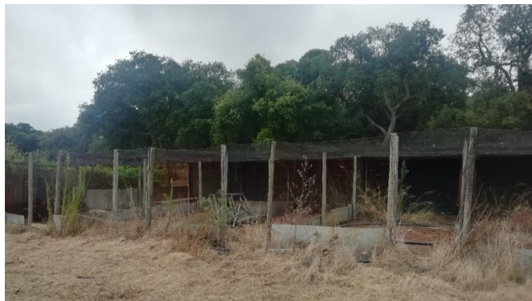
Instalações antes das intervenções. Vista frontal (em cima) e lateral (em baixo). Fotografias de 6 de agosto de 2019.
