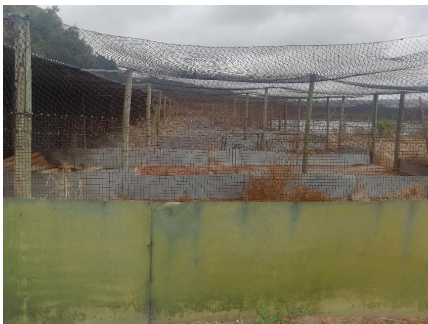
Instalações antes das intervenções. Vista posterior (em cima) e lateral direita (em baixo). Fotografia de 6 de agosto de 2019.
